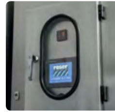
Cuadro eléctrico con PLC Control box with PLC
