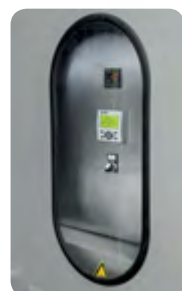
Cuadro eléctrico con PLC Control box with PLC
